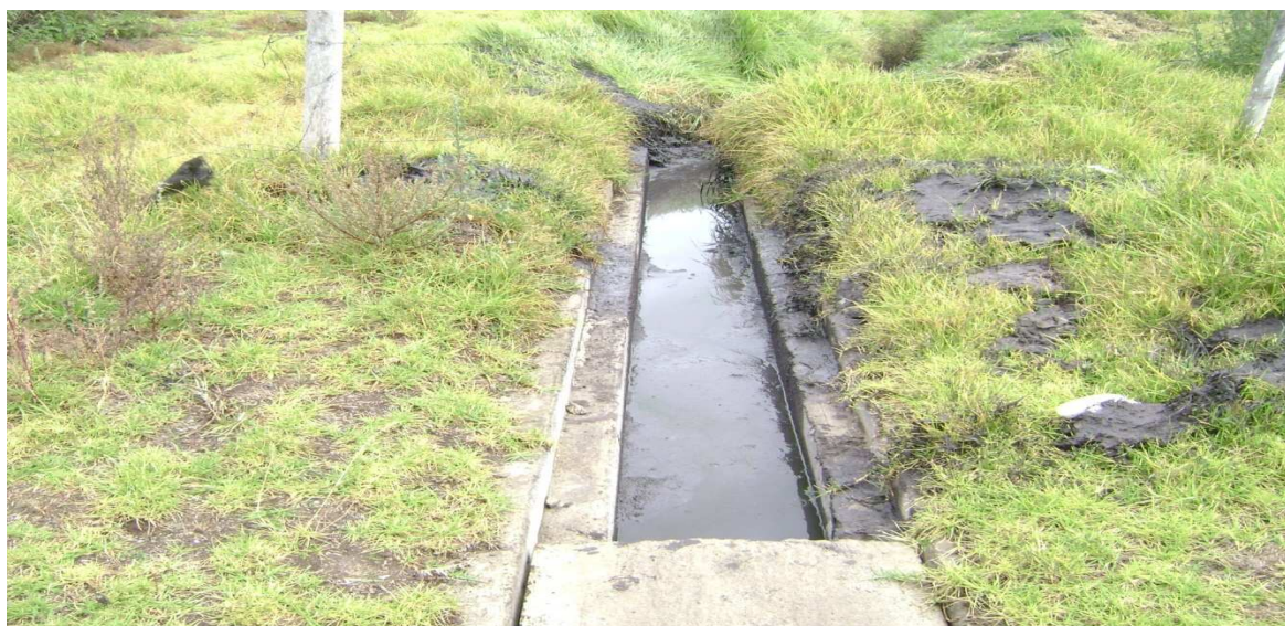
Figura 4. Canales de desagüe de residuos líquidos del Laboratorio de Curtiembre.
