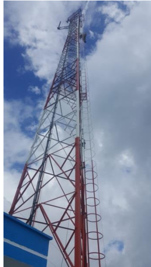
Figura 14-4. Torre autoportada existente_sitio (B) Repetidor Dos Ríos Alluriquin. Fuente: Aucancela Luis, 2018
