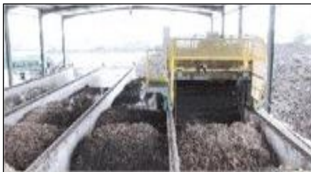
Figura 3-1: Máquina volteadora en trincheras.
