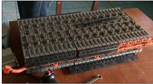
Figura 10-4: Pack de baterías
