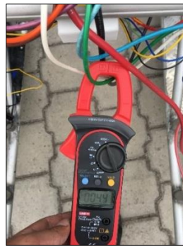
Figura 18-4: Medición del amperaje requerido por los motores
