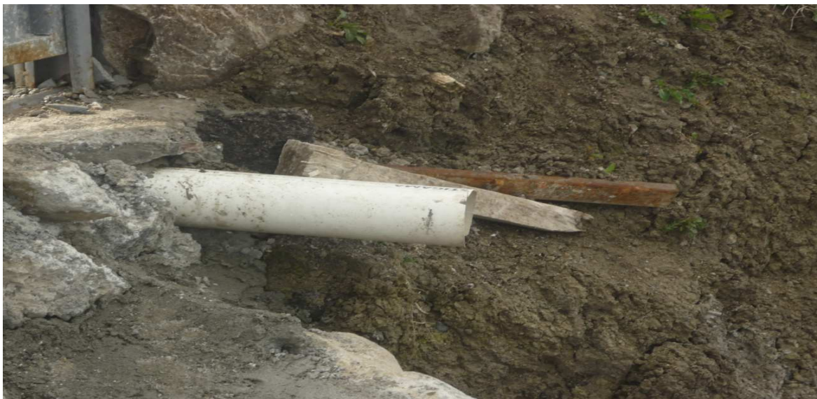
Gráfico 5. Tuberías para vertido de efluentes líquidos.
